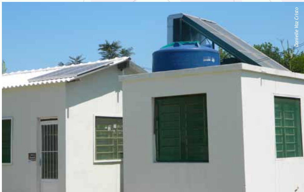
Centro de salga e secagem de pescado: energia gerada por painéis fotovoltaicos e calor produzido por placas de aquecimento solar
