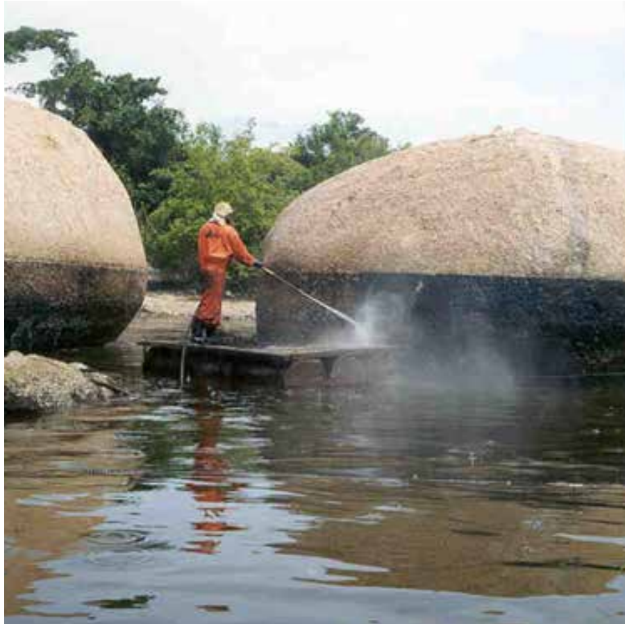
Figura 26: Limpeza de costão pela técnica de jateamento com água Fonte: Banco de imagens Cetesb
