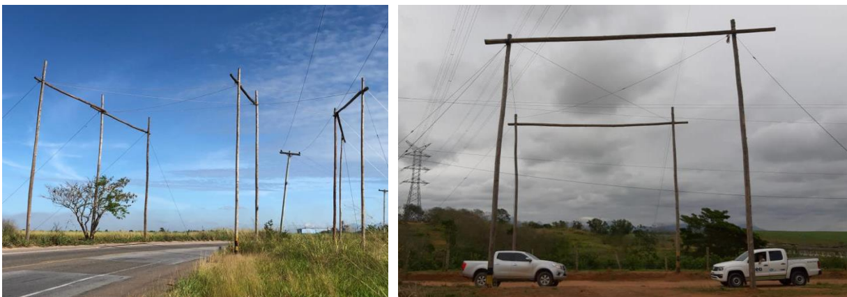
Figura 10.2. Exemplos de estruturas de travessias de proteção de vias instaladas pelo empreendedor.
