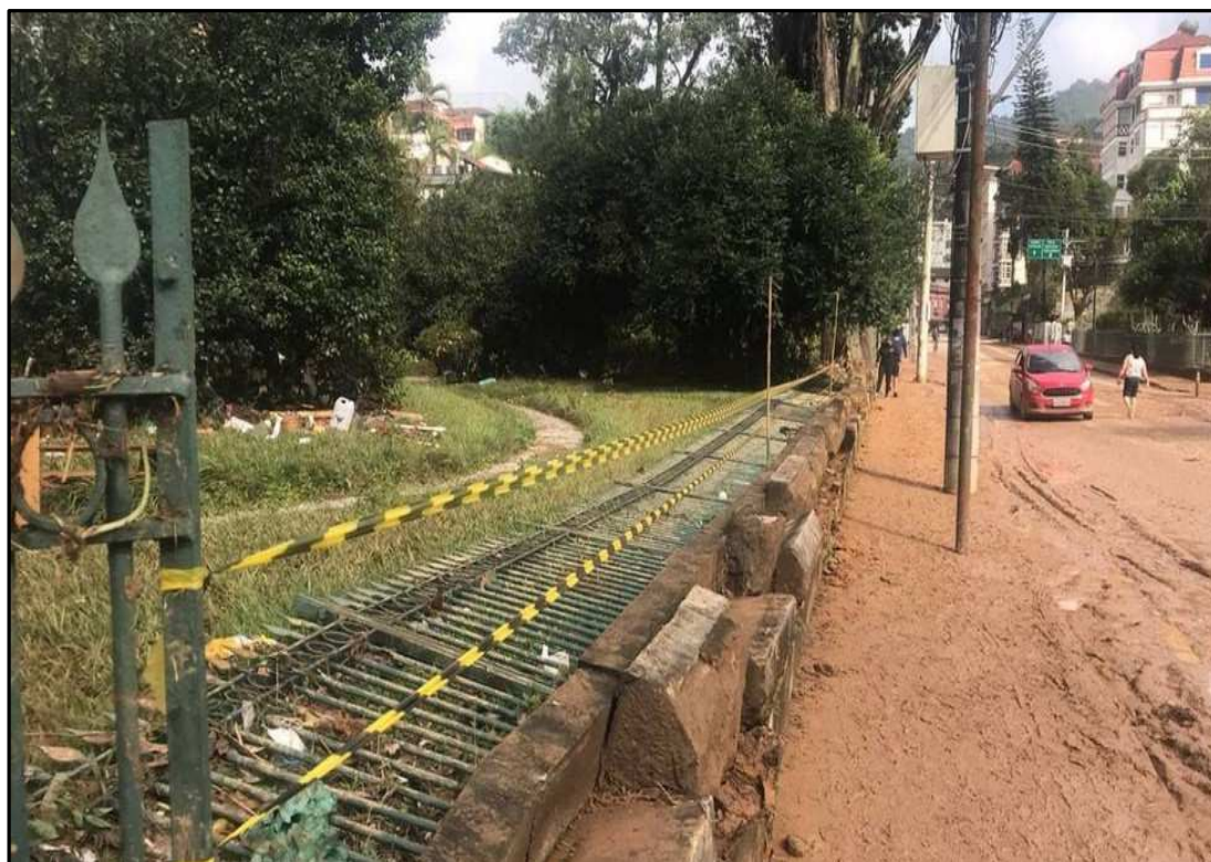
Figura 9-17 - Muro da Casa da Princesa Isabel Destruído pela Força das Águas na Enchente de 15 de fevereiro de 2022
