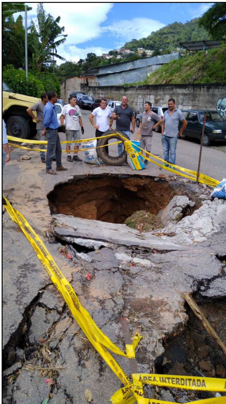
Figura 9-16 - Trecho do Túnel Extravasor na Rua do Túnel Danificado em 2021
