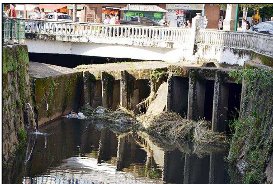
Figura 7-13 - Tomada do Túnel Extravasador do Rio Palatinato Obstruída
